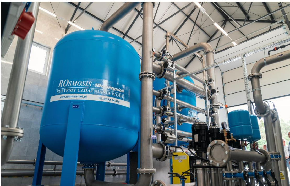
Rysunek 3 Wnętrze nowo wybudowanej stacji uzdatniania wody w Nowej Wsi Zbąskiej.
